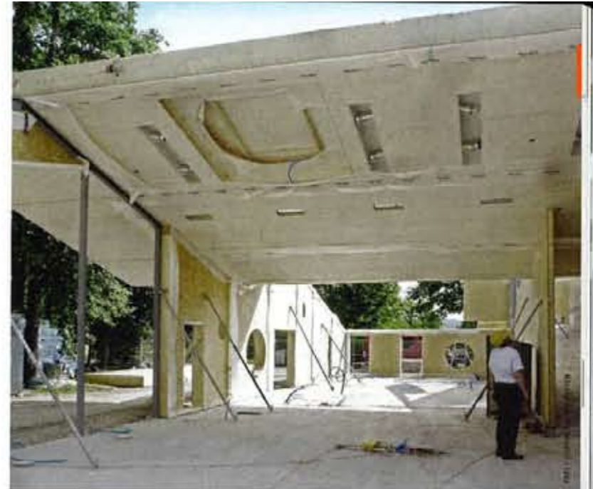
▶ Foyer im Rohbauzustand: Holzrahmenbau-Wände und Stahlrahmen dienen den auskragenden Dachelementen in Holzbauweise als äußere Auflager
